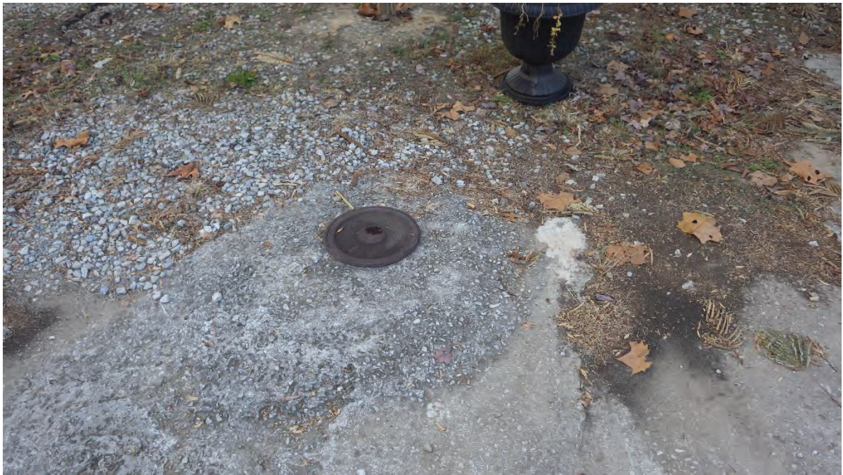
UST fill port
