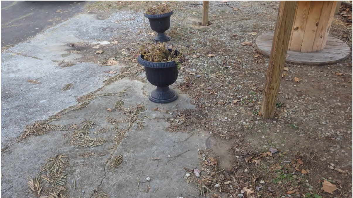
UST fill ports
